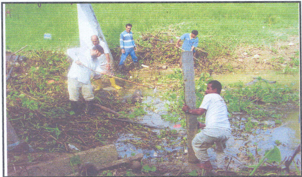
PEKERJA JABATAN TERPAKSA MEMBUANG SAMPAH YANG BERADA DI INTAKE.
